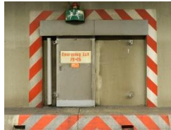
Cross Passage Door
